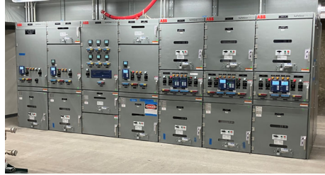
OOBS 12kV Switchgear
