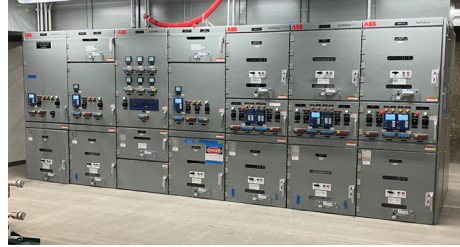
OOBS 12kV Switchgear
